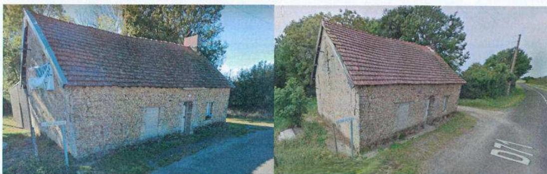
Figure 8 : Photos la Croix des Landes - Source : Google maps, octobre 2021 et en mai 2011
